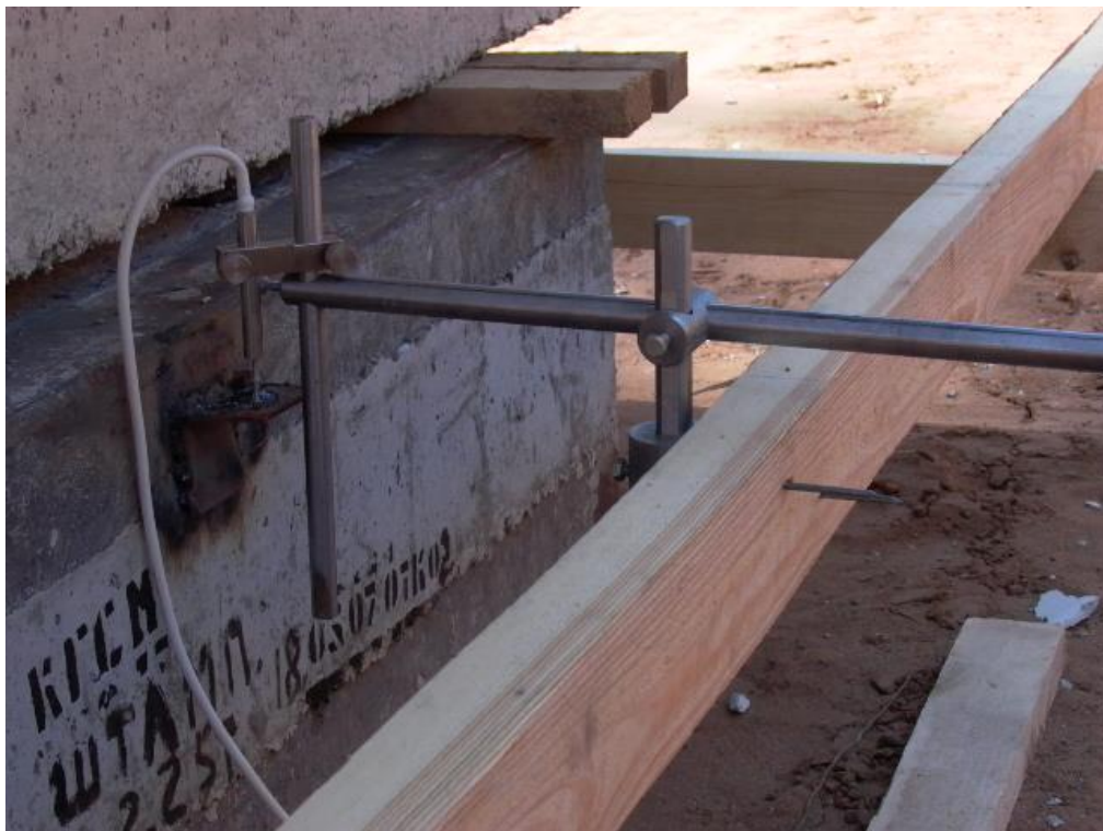
Рис. 7. Датчик перемещений и его крепление к реперной системе
